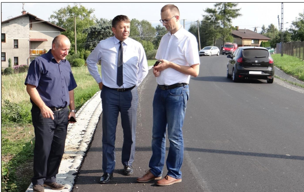
Ocena wykonania prac przy drodze powiatowej 2621 S na odcinku ulicy Cieszyńskiej w Zamarskach
