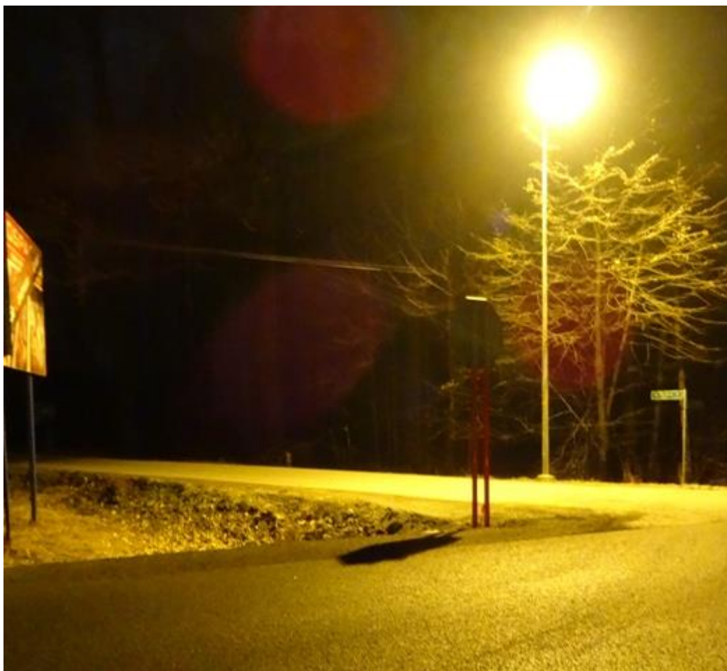
Punkt świetlny na skrzyżowaniu ul. Parchów z ul. Cieszyńską w Hażlachu
